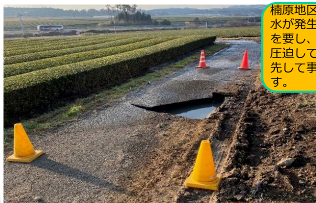
埋設管の漏水状況
